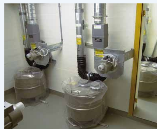
Lüftungen und Filter sichern das Überleben der Menschen im Schutzraum
